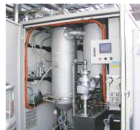
廃液処理装置
