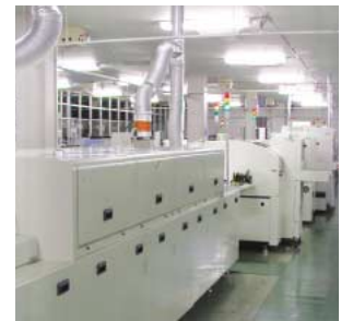
辰野事業場の鉛フリーはんだリフローライン
