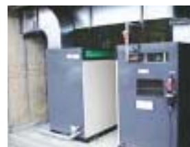
日の出工場の小型コンプレッサー
