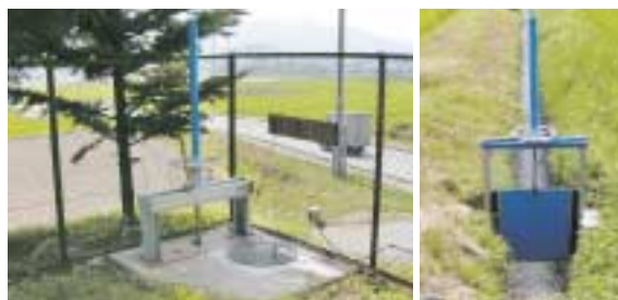
緊急遮断ゲート
