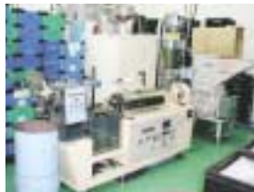
廃樹脂再生設備
