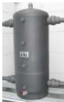
■上水再生装置の一部
