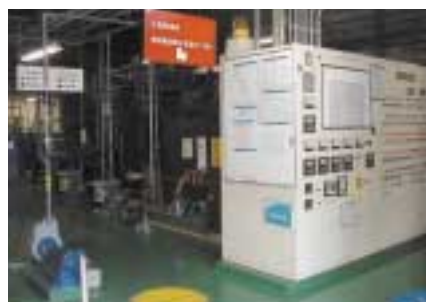
■ 排水処理装置(辰野事業場)
