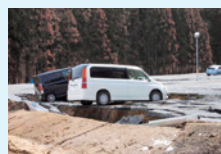
白河事業場の駐車場の液状化
