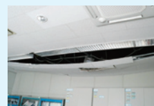
白河事業場の天井板落下
